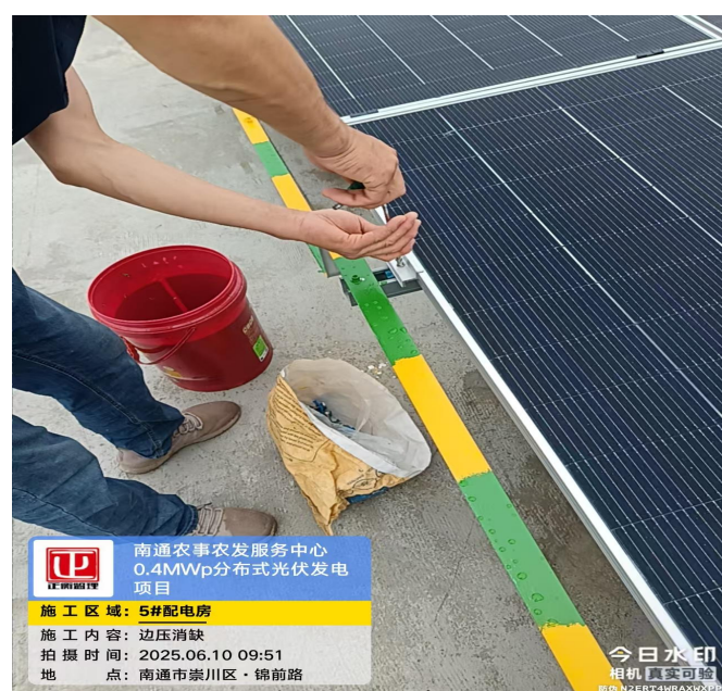
5#配电房边压消缺
