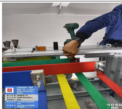
并网柜螺栓检查
