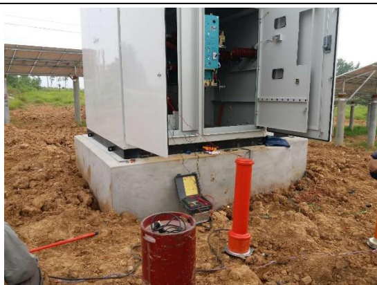
箱逆变耐压实验
