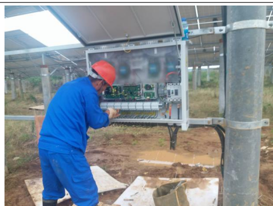
23 区汇流箱接线
