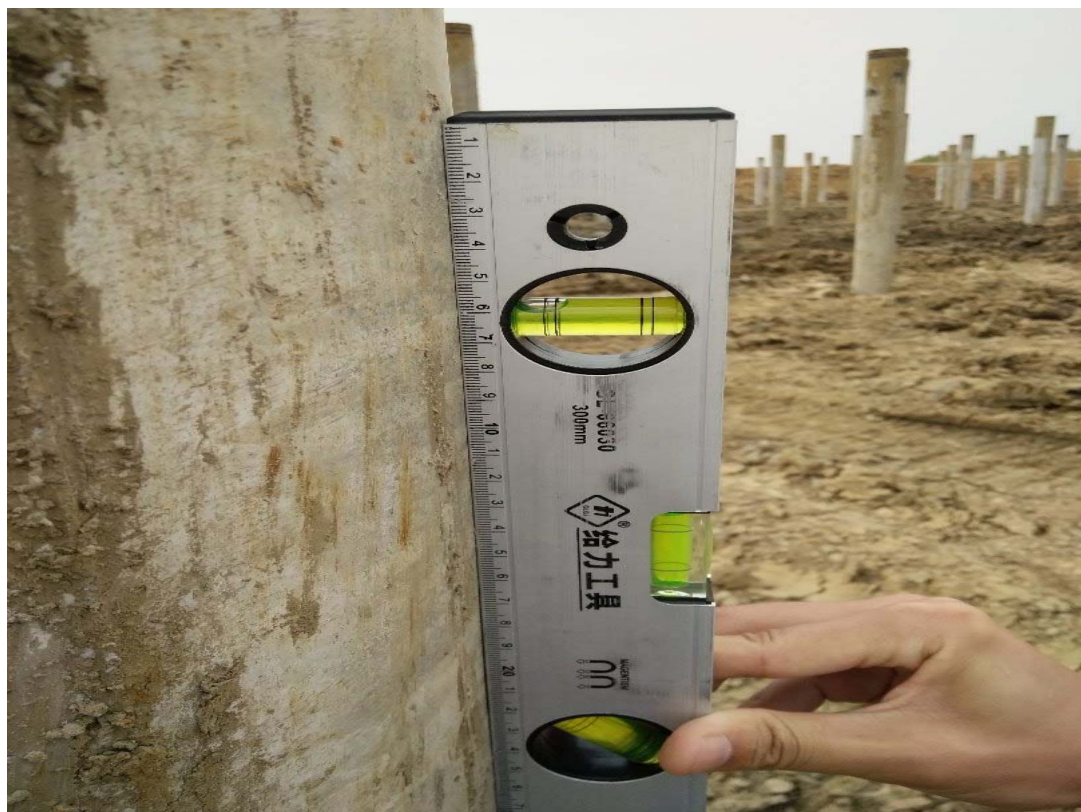
桩基施工垂直度偏差较大
