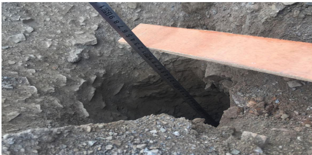
3、王三沟光伏场区电缆沟回填未经报验擅自回填
