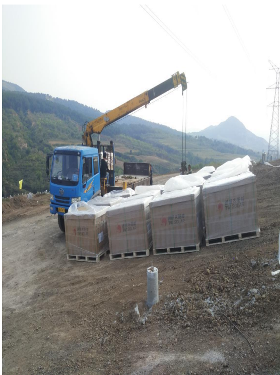
高压线下吊装作业，发现后要求立即停止施
