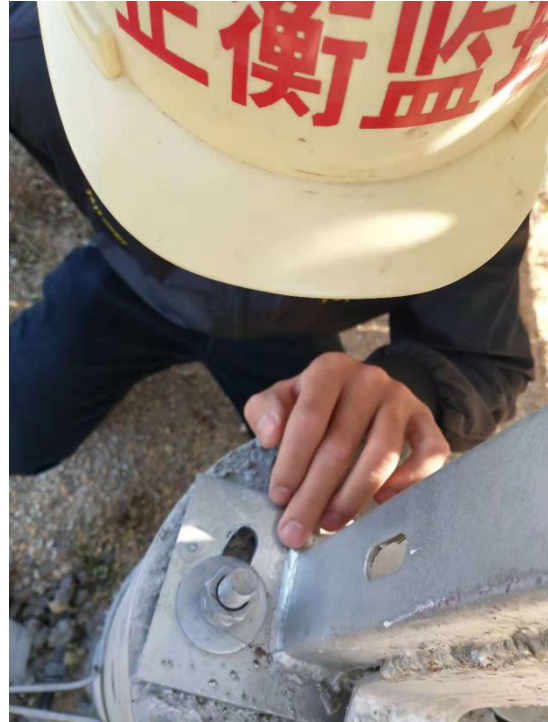
王三沟场区支架底座开裂未整改
