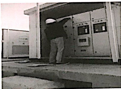
光伏区箱变高压送电
