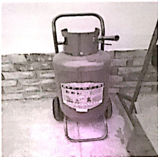
站内消防设施（干粉灭火器）
