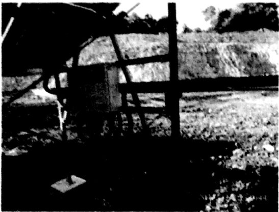
光伏区现场巡视
