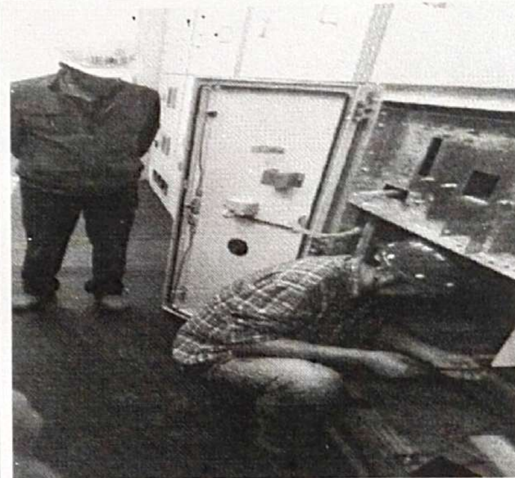
35KV 配电柜进线检查
