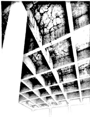
P4 区电气楼屋面严重渗漏
