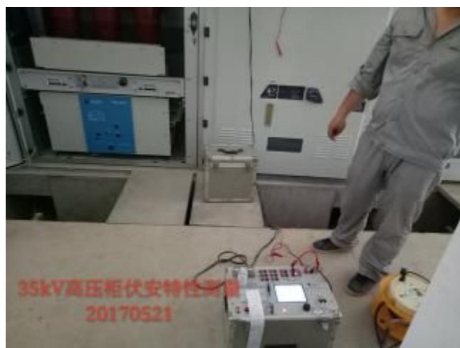
35kV 高压柜伏安特性测试
