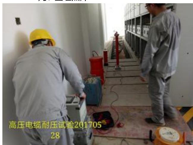
高压电缆耐压试验 20170528
