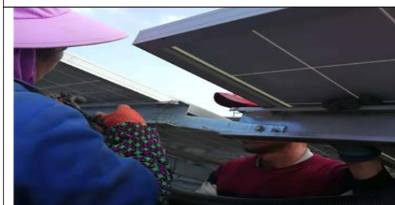
光伏东区18号方阵相邻两组支架接地 扁铁螺栓连接
