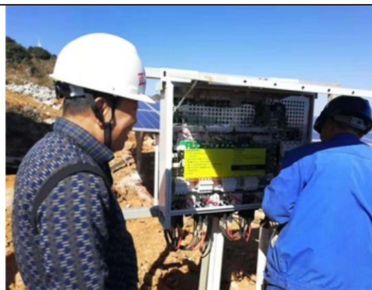
光伏东区20号方阵汇流箱开路电压测试.
