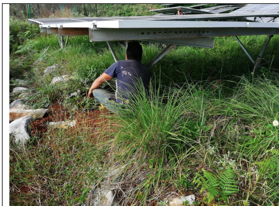
光伏区支架生锈螺栓更换
