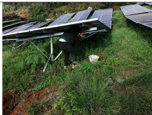
光伏区支架生锈螺栓更换
