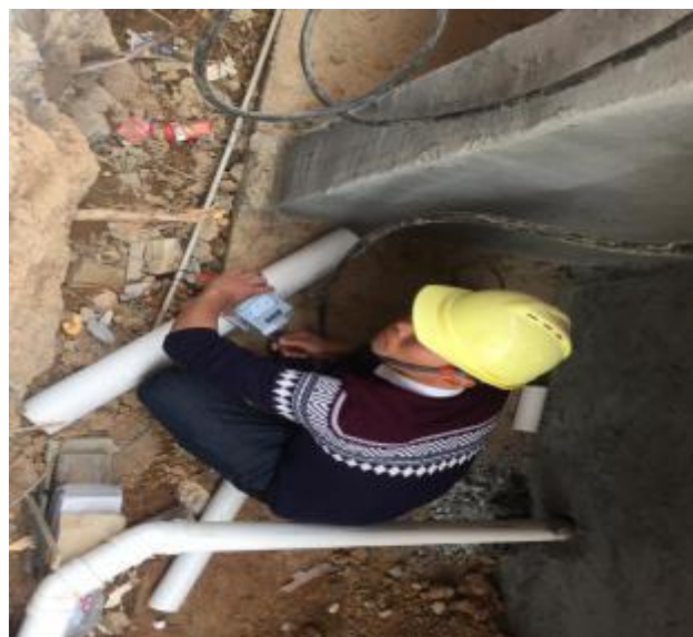
设备基础接地电阻测试
