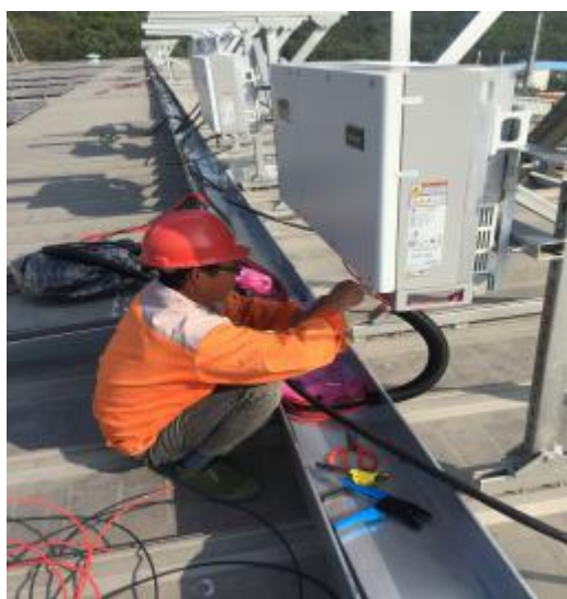
屋面逆变器接线
