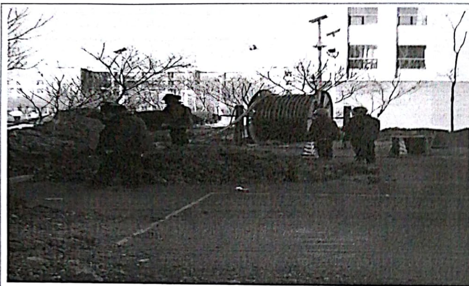
北区放高压电缆
