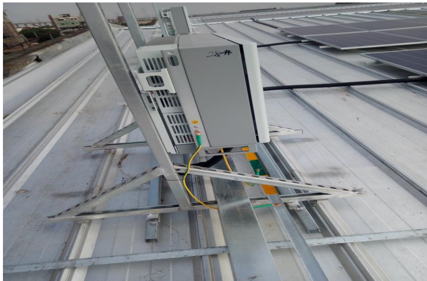
宏嘉逆变器接线完成
