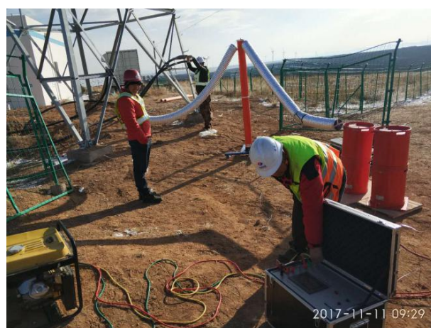
高压电缆头耐压试验
