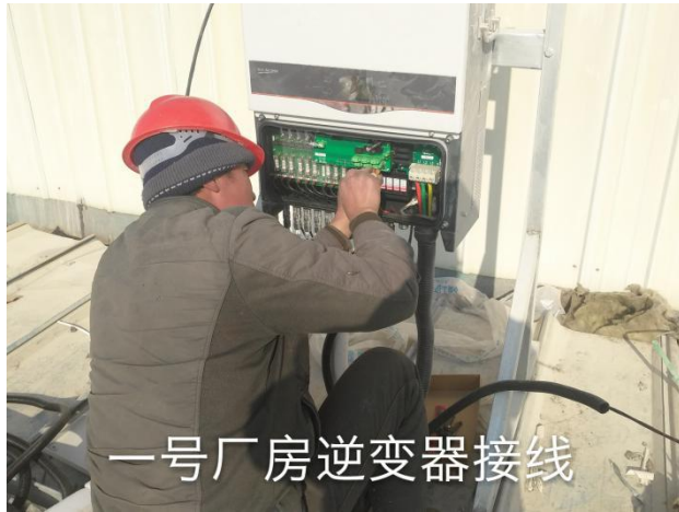
一号厂房逆变 器接线
