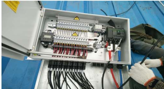
汇流箱接线检查
