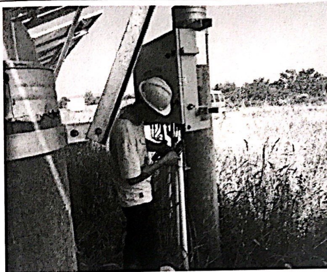
15 区汇流箱电流检测
