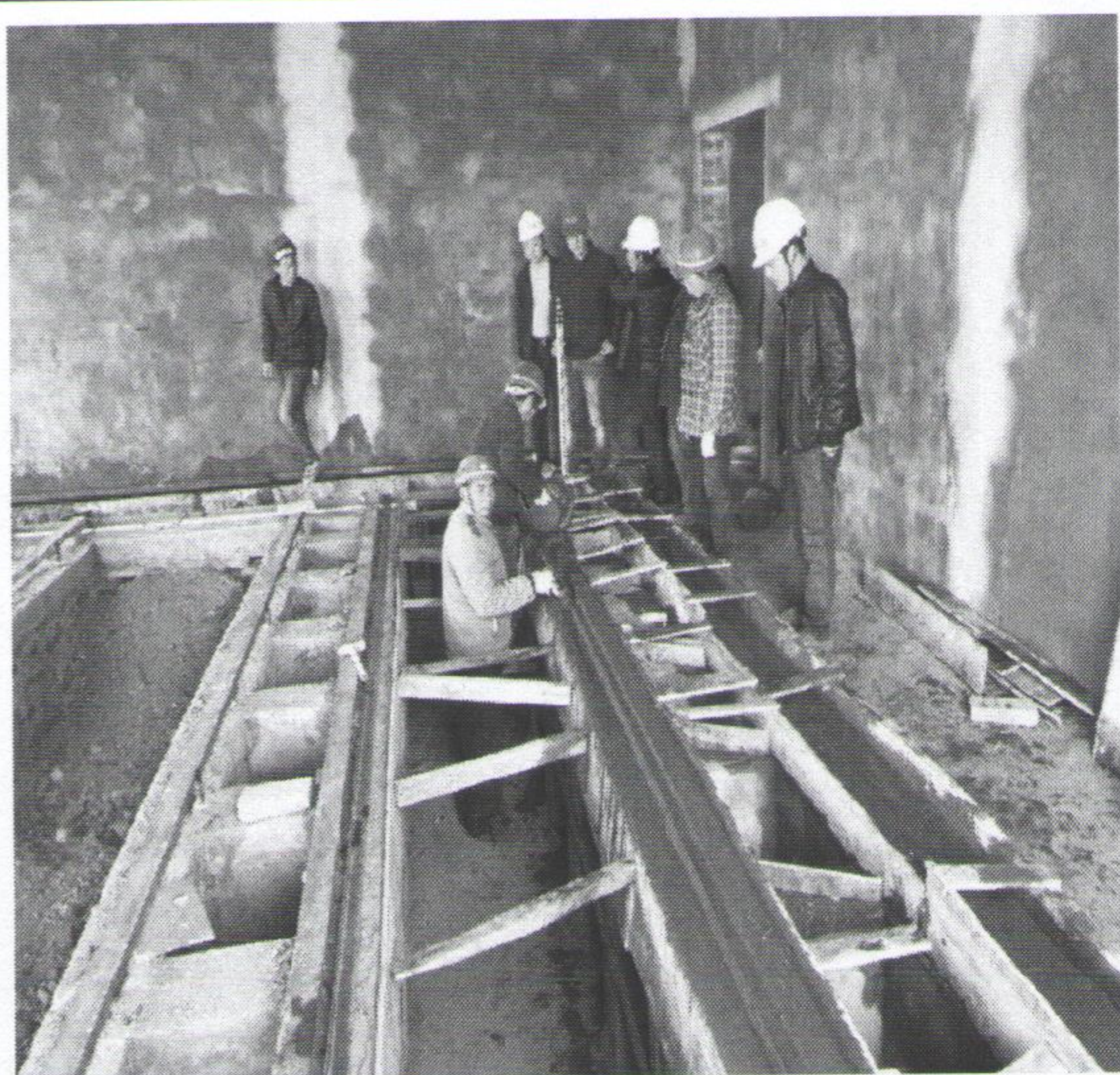
上电领导检查配电楼
