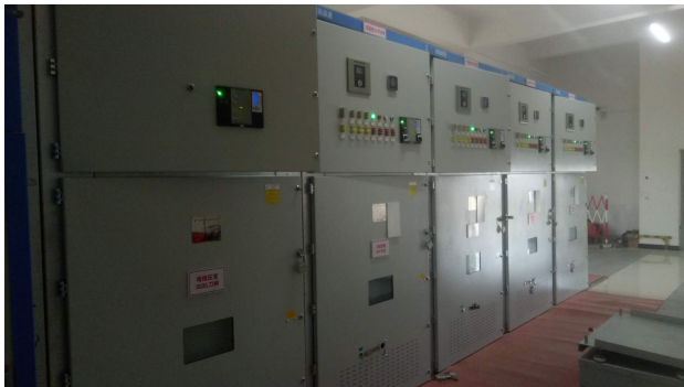
检查高压开关柜
