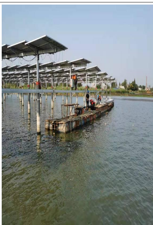
23 区汇流箱整改
