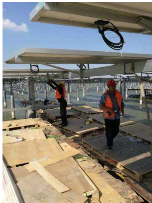
光伏区组件背板接线
