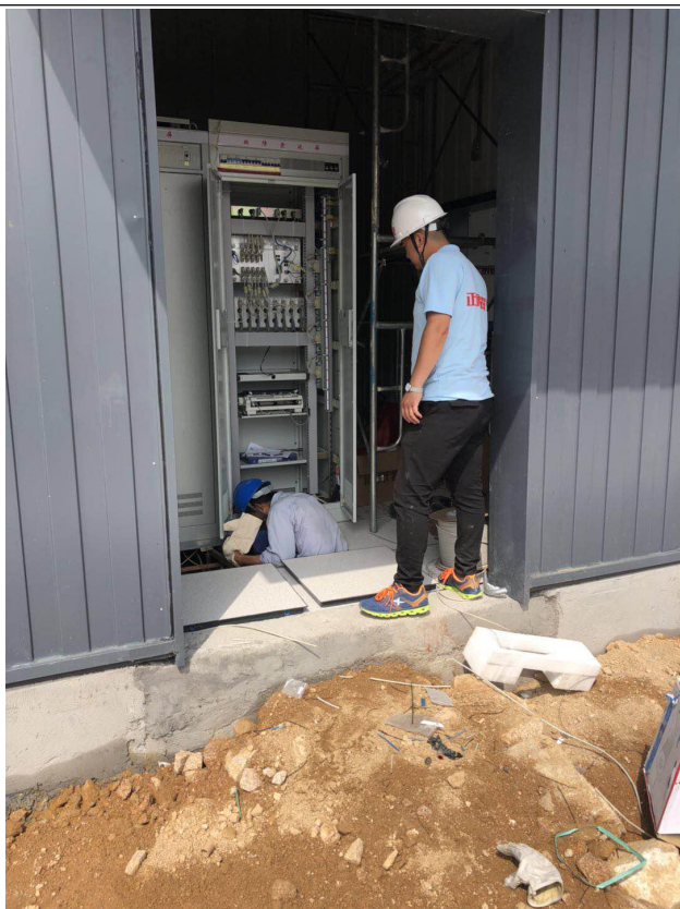
升压站设备检查
