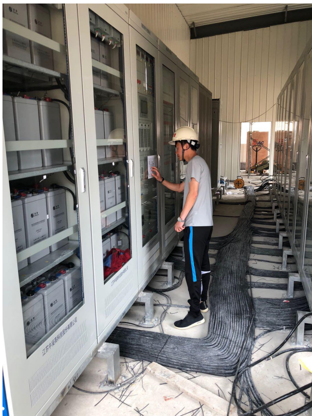
升压站设备检查
