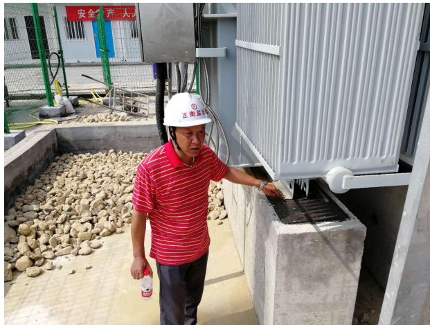
检查变压器接 地整改情况
