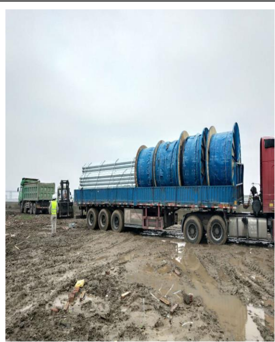
35kv 电缆到货
