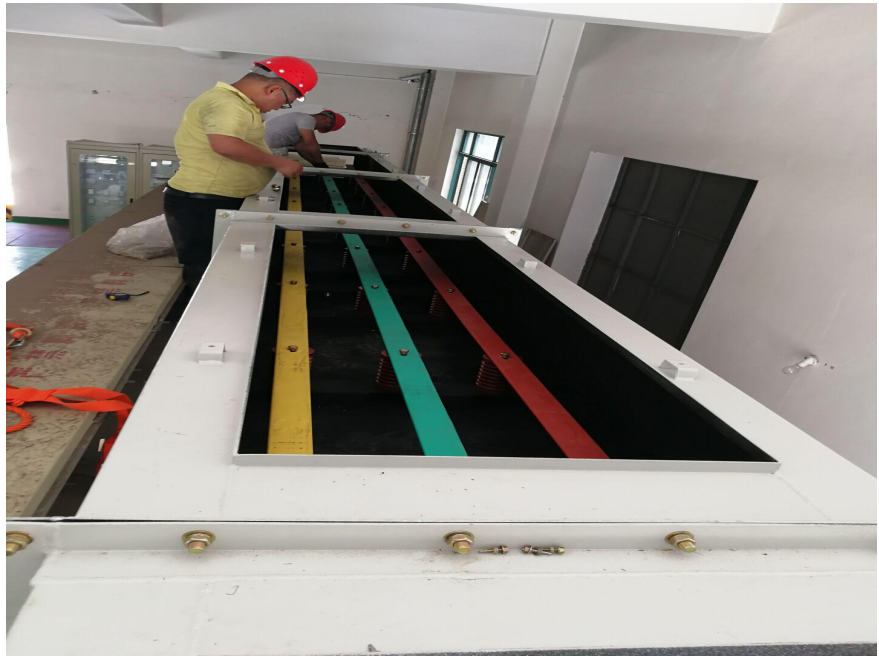
光伏并网柜母线排连接
