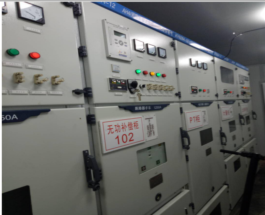
设备运行检查
