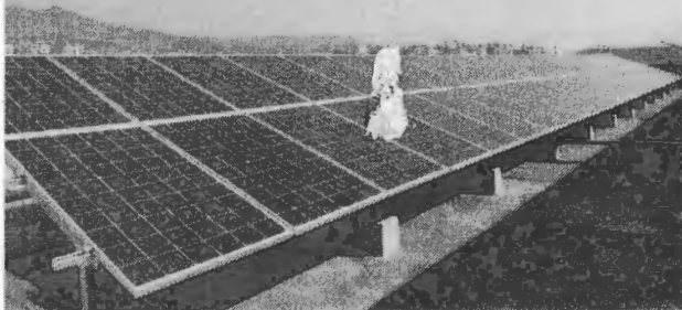
瑞金市“十二五”贫困村光伏扶贫扩面工程 厂房屋顶光伏组件20181125
