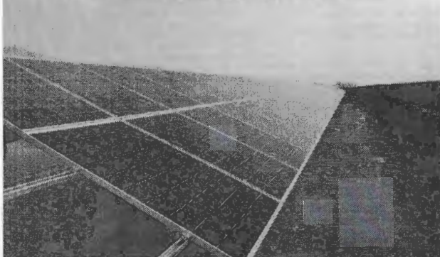
瑞金市“十二五”贫困村光伏扶贫扩面工程 希艺欧厂房屋顶光伏组件20181119
