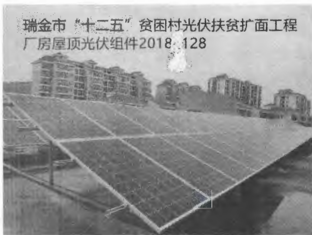
瑞金市“十二五”贫困村光伏扶贫扩面工程 厂房屋顶光伏组件20181129
