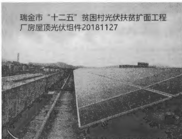
瑞金市“十二五”贫困村光伏扶贫扩面工程 厂房屋顶光伏组件20181128
