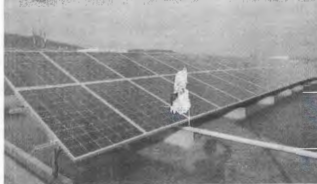
瑞金市“十二五”贫困村光伏扶贫扩面工程 红都兴厂房屋顶光伏组件 20181110
