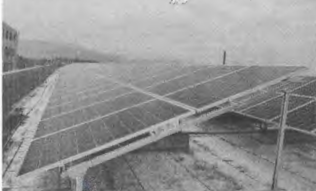
瑞金市“十二五”贫困村光伏扶贫扩面工程 乐群塑胶厂房屋顶光伏组件20181120
