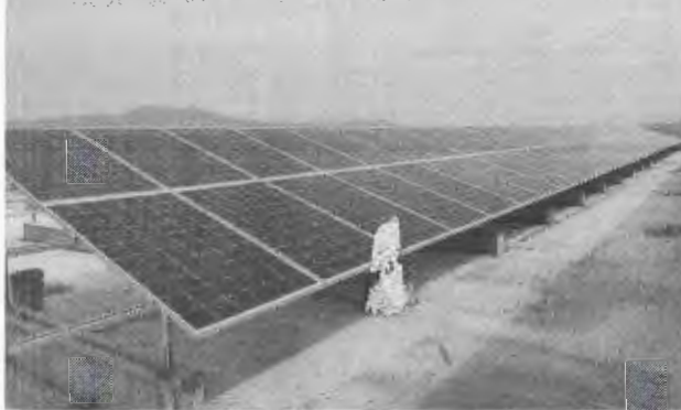
瑞金市“十二五”贫困村光伏扶贫扩面工程 希艺欧厂房屋顶光伏组件20181118
