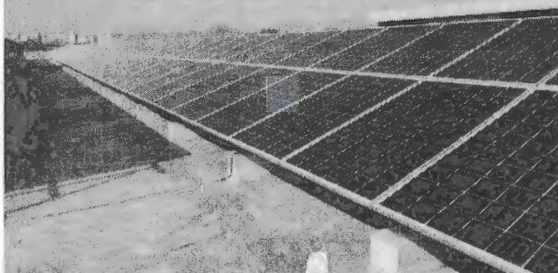
瑞金市“十二五”贫困村光伏扶贫扩面工程 厂房屋顶光伏组件20181126
