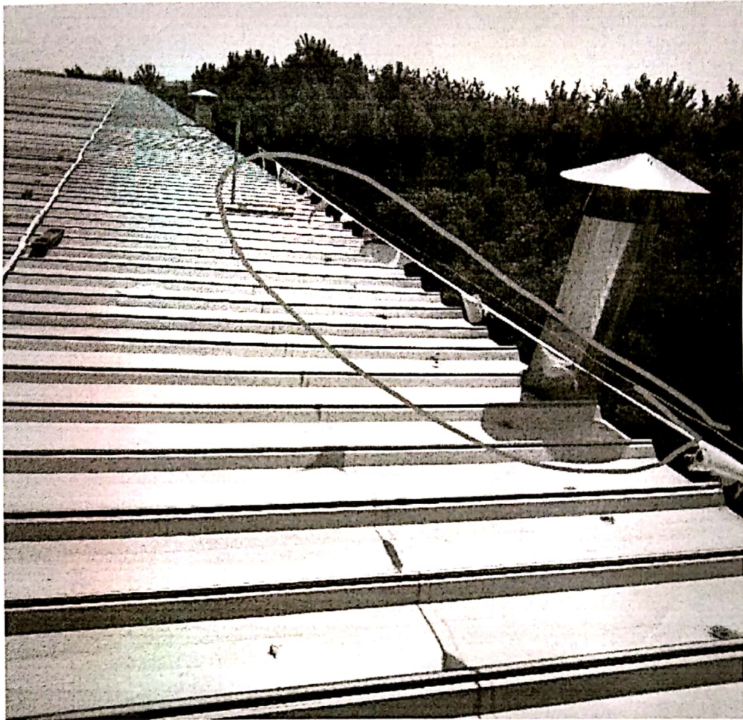
10号屋顶临边安全防护不规范（02）
