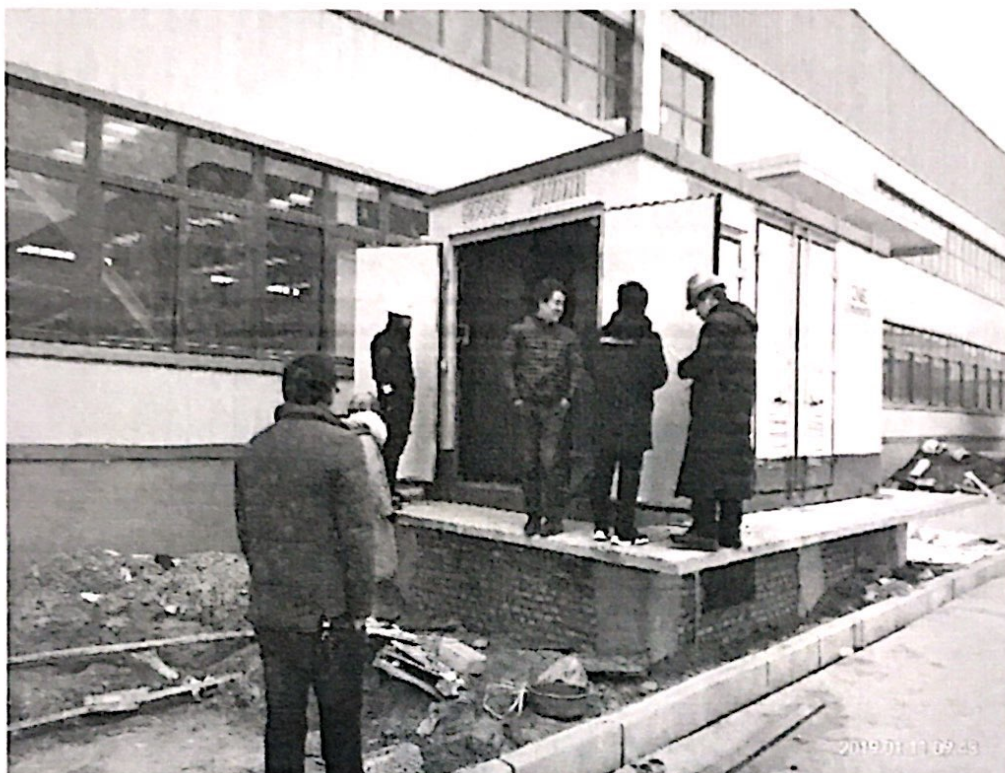
并网发电箱逆变器检查
