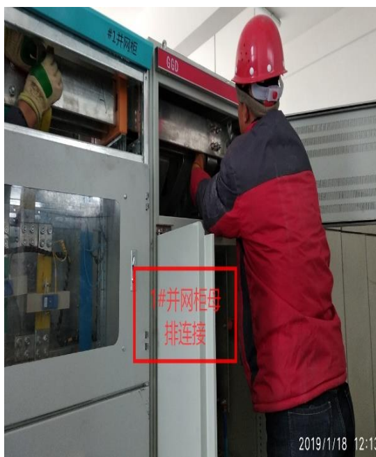
1#并网柜安装母排
