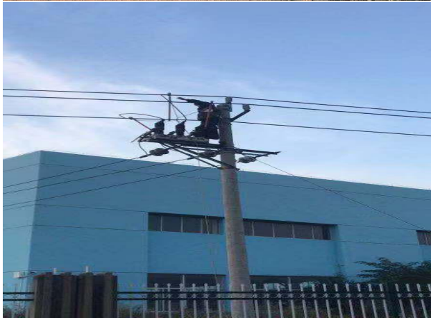
南线上杆断路器
