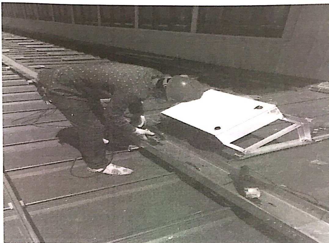
11#屋面汇流箱安装
