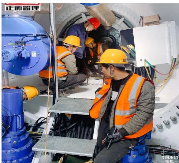
13#机位机舱内电气验收
