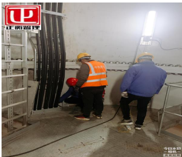
13#机位塔筒内电气验收
