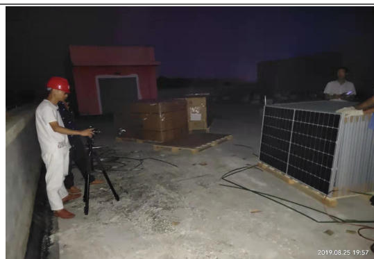
组件到货隐裂检测
