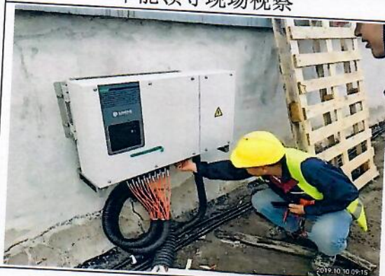
逆变器带电运行
