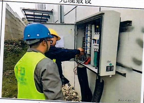
汇流箱带电前检查
