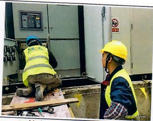
2#箱变低压侧连接低压电缆
