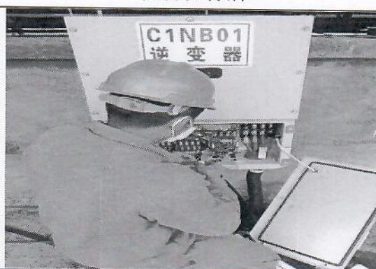
逆变器通讯线路连接
