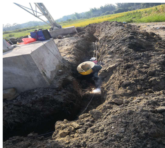
钦州康熙岭渔光一体光伏电站（三期）
