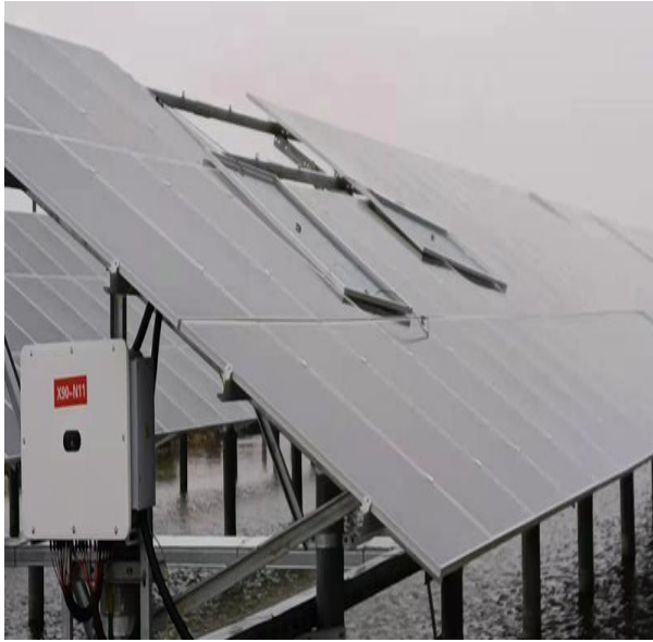
现场组件被吹翻
