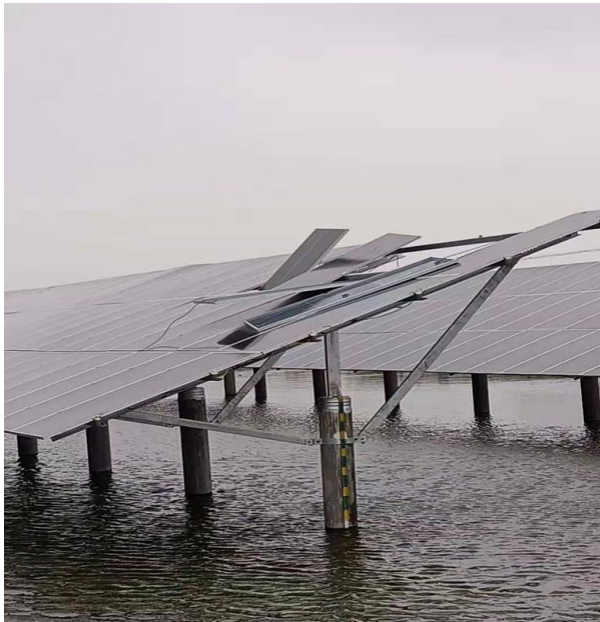
现场组件被吹翻 01
