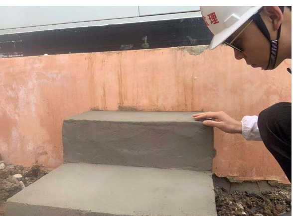
箱变阶梯检查
