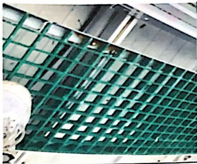
运维通道紧固件生锈
