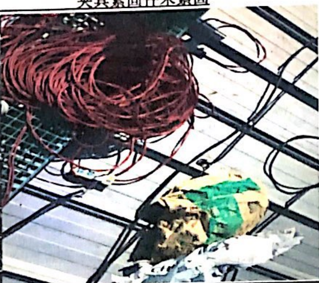
移动用电未见移动配电箱
