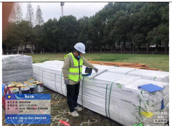
现场临边安全防护
