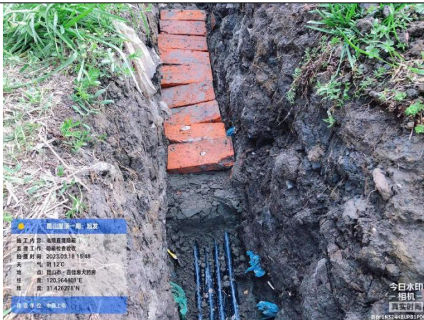
旭发项目供电公司验收
