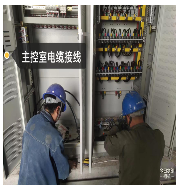
主控室电缆接线
